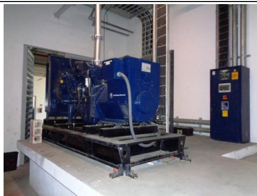
Planta de emergencia
